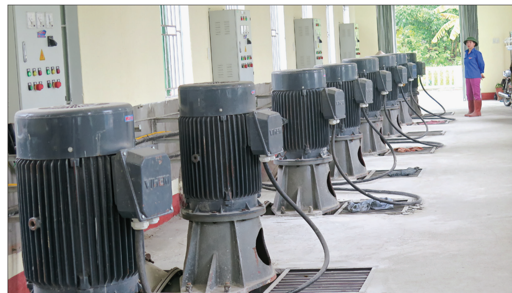
Trạm bơm Lịch Bài (xã Vũ Hòa, huyện Kiến Xương) thường xuyên được kiểm tra, bảo dưỡng, bảo đảm vận hành an toàn trong mùa mưa bão.
