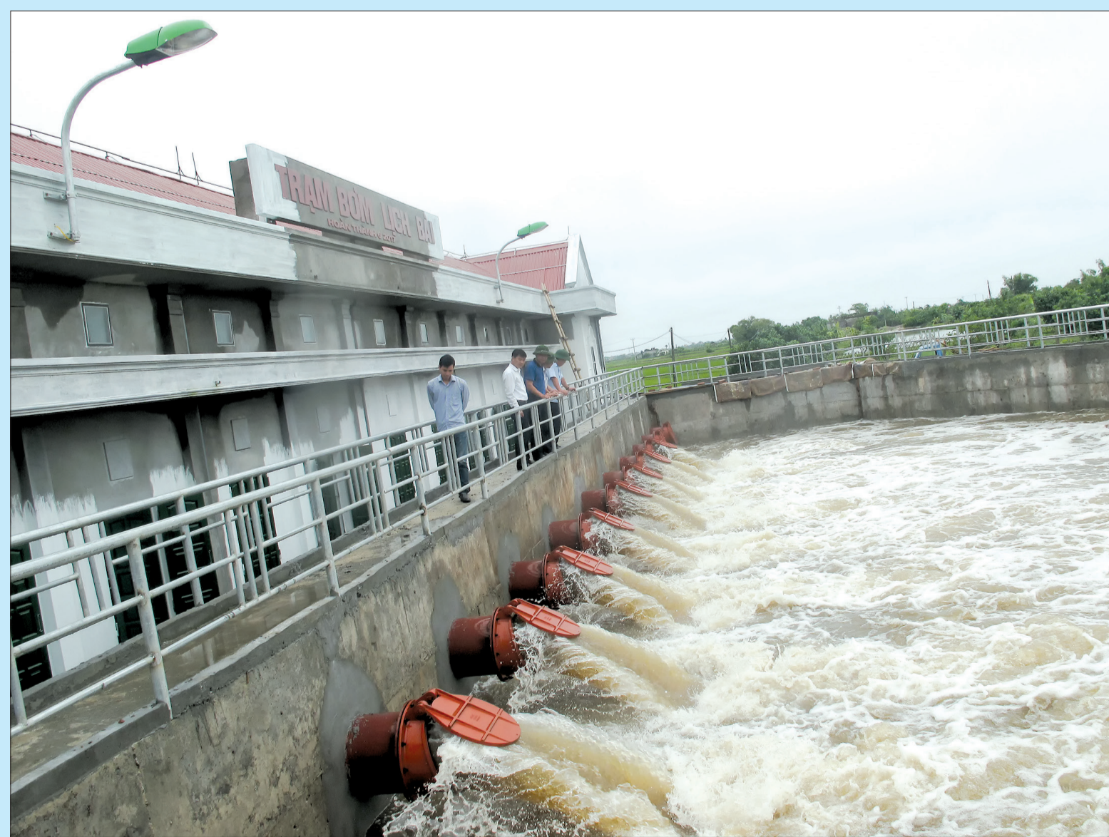
Trạm bơm tiêu Lịch Bài (Kiến Xương).
