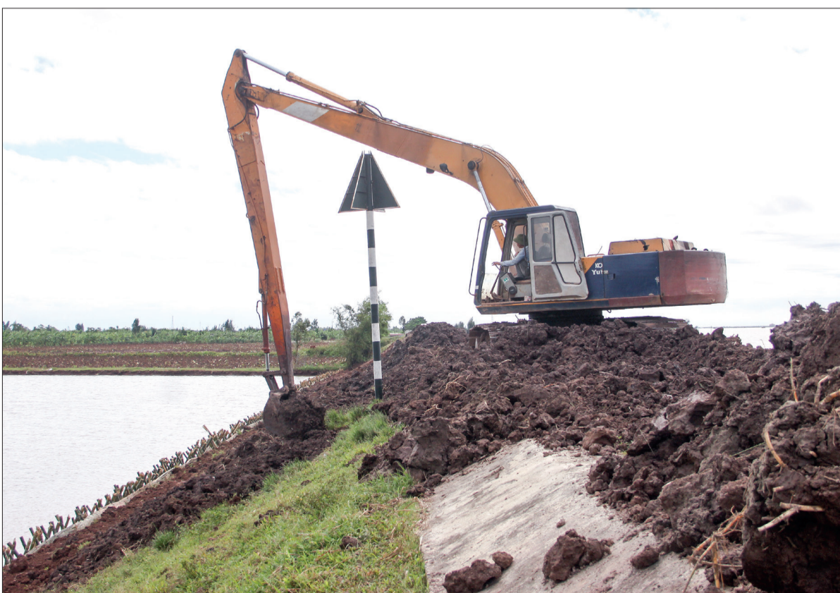
Huyện Tiên Hải huy động nhân lực, vật tư, phương tiện xử lý sự cố sạt lở mái đê phía trong đồng đê cửa sông tả Hồng Hà, đoạn qua địa phận xã Nam Hồng.
