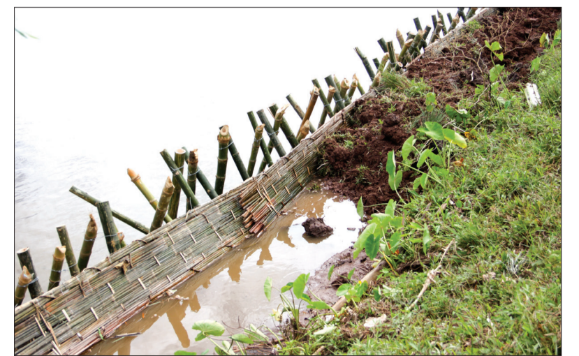
Sự cố sạt lở mái đê phía trong đồng đê cửa sông tả Hồng Hà, đoạn qua địa phận xã Nam Hồng được xử lý.
