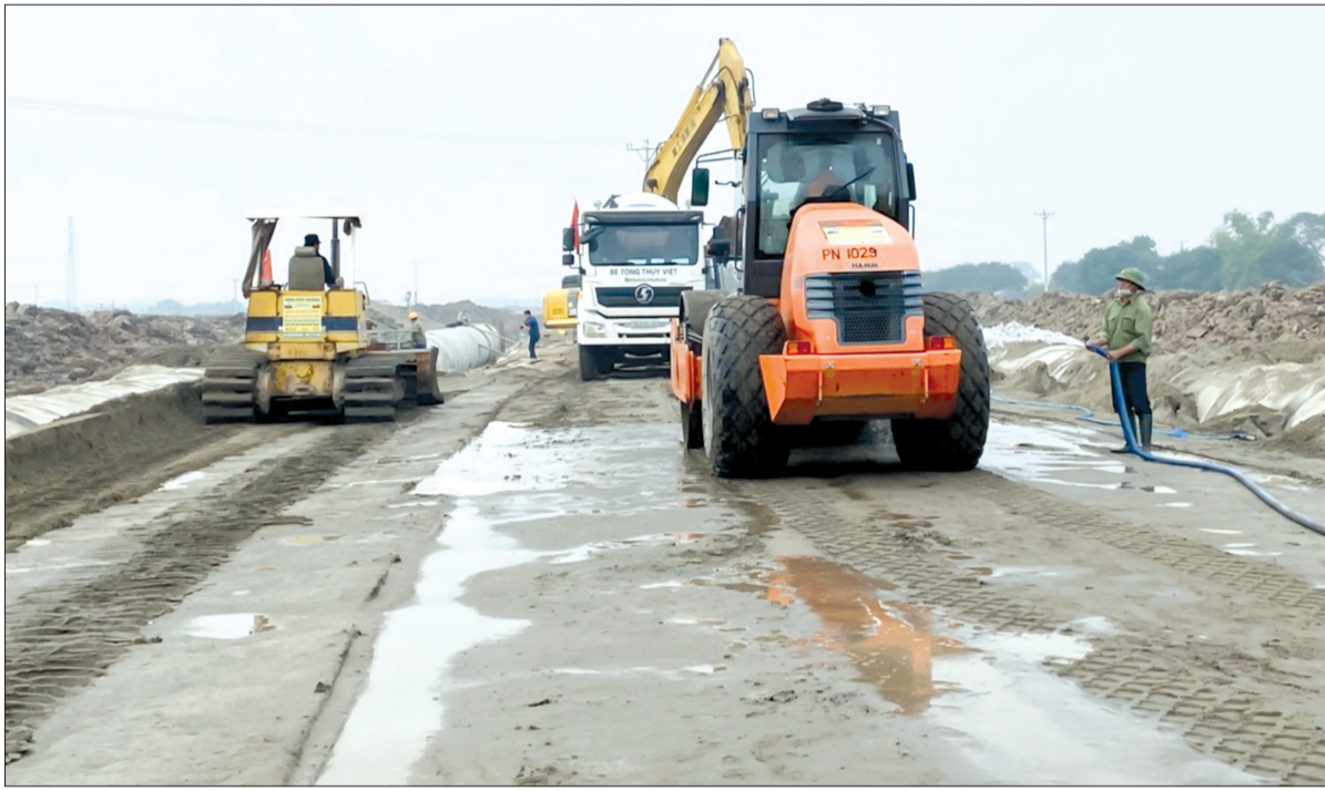
Thi công tuyến đường nội bộ trong Khu kinh tế Thái Bình.
