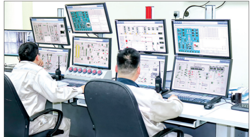
Giám sát hệ thống vận hành sản xuất điện tại Nhà máy nhiệt điện Thái Bình.
