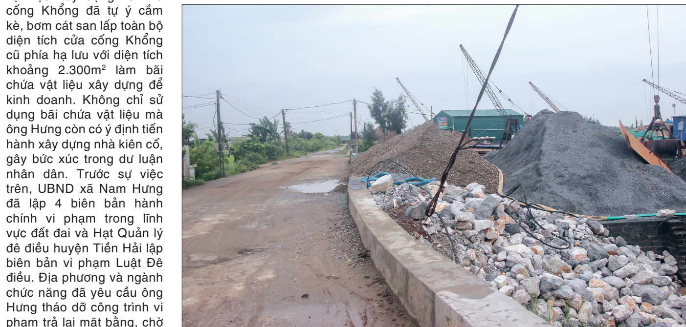
Chủ hộ kinh doanh chất tải vật liệu xây dựng lên mái đê.
