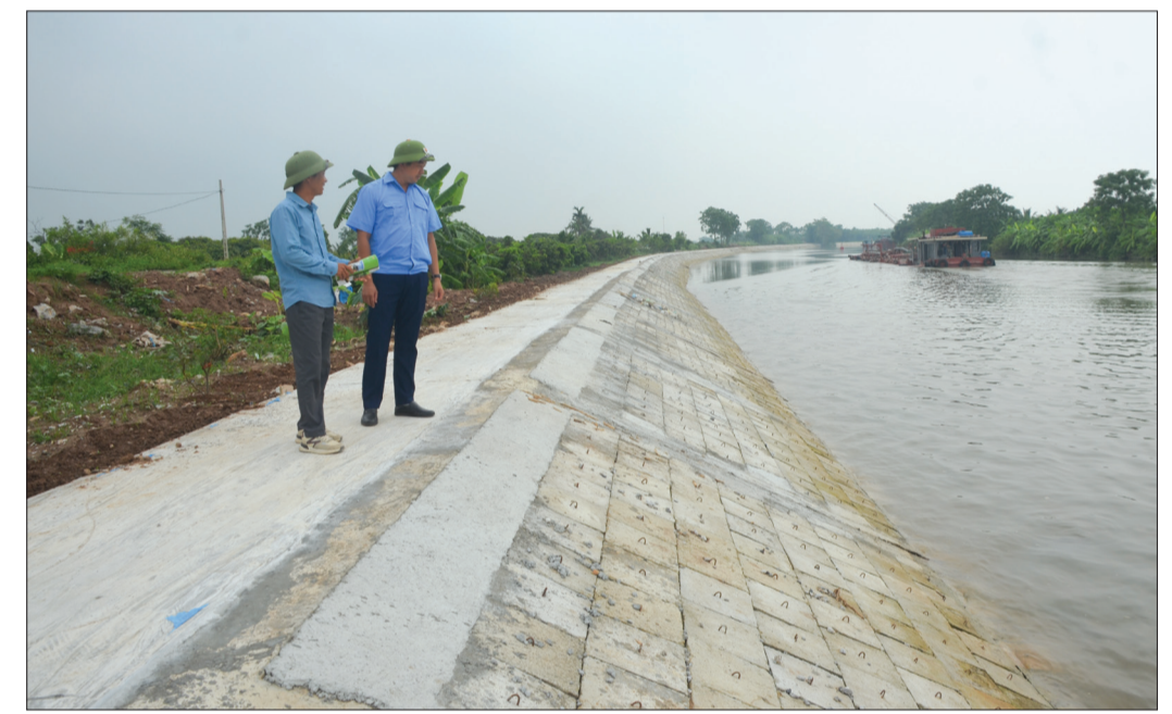
Hạt Quản lý đê huyện Quỳnh Phụ kiểm tra chất lượng hệ thống kè bãi lở ở xã An Khê.
