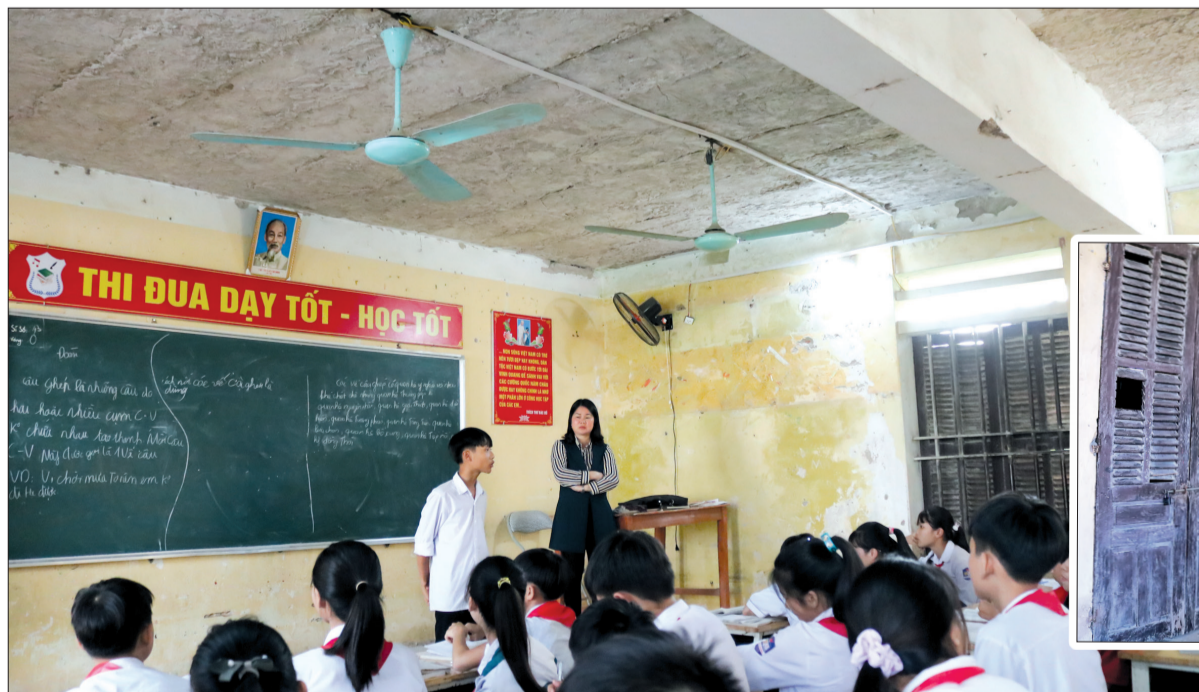
Cô và trò Trường Tiểu học và THCS Đô Lương đang dạy và học dưới chiếc quạt trần được bắt vít lên trần nhà trong tình trạng lớp bê tông trần nhà đã xuống cấp.
