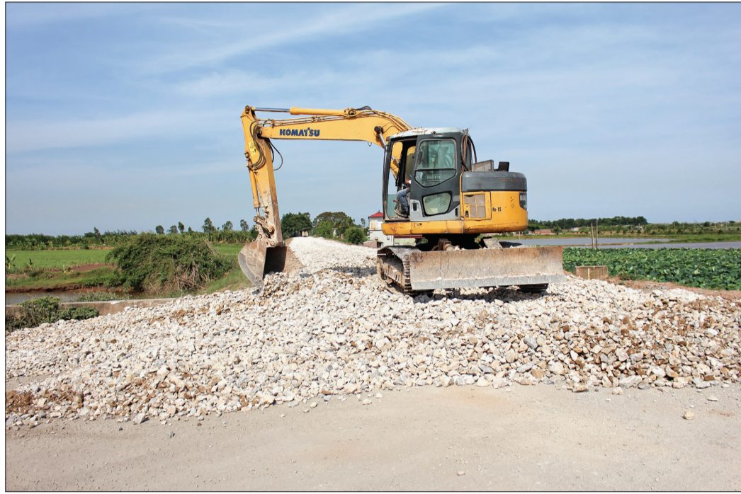
Thi công đê cửa sông Hữu Hóa, đoạn từ K2+900 đến K7+000, đoạn qua xã Hồng Dũng (Thái Thụy).
