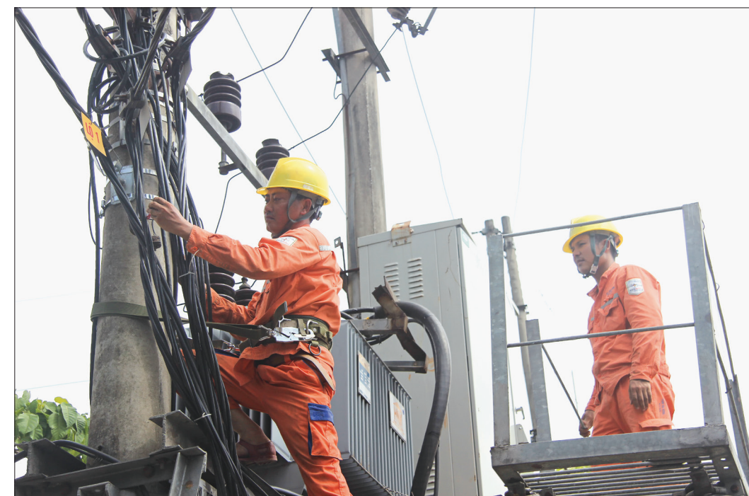
Công nhân Điện lực Đông Hưng kiểm tra trạm biến áp để bảo đảm cấp điện ổn định, an toàn.
