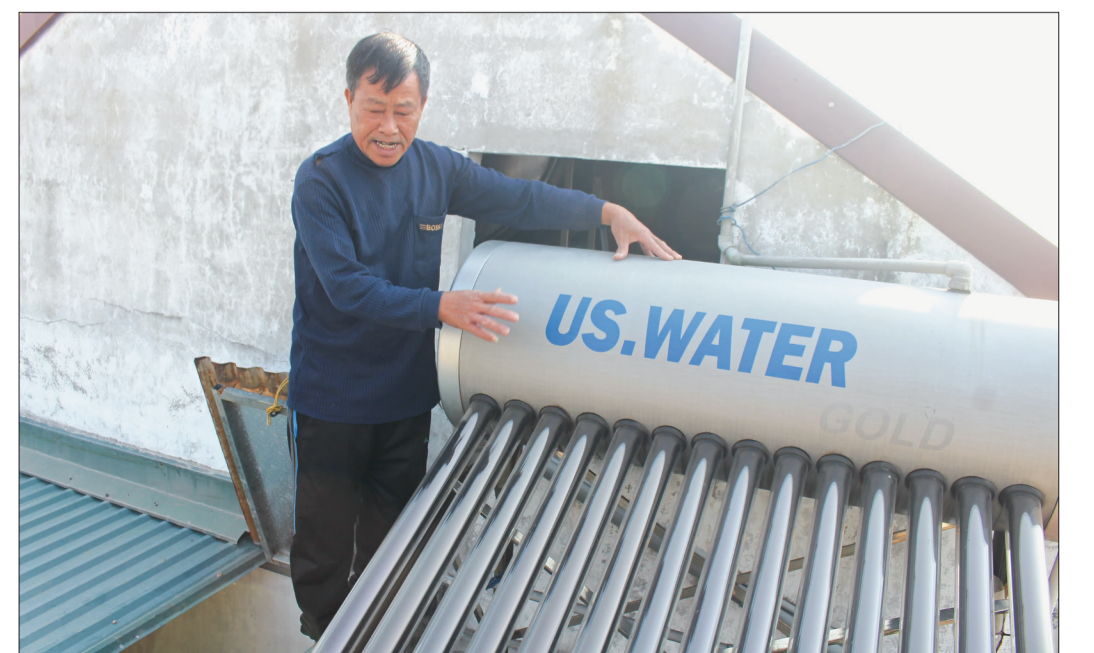
Gia đình ông Bùi Văn Tiên ở thôn Mộ Đạo 2, xã Vũ Bình (Kiến Xương) tiết kiệm chi phí tiền điện nhờ lắp bình nước nóng năng lượng mặt trời.
