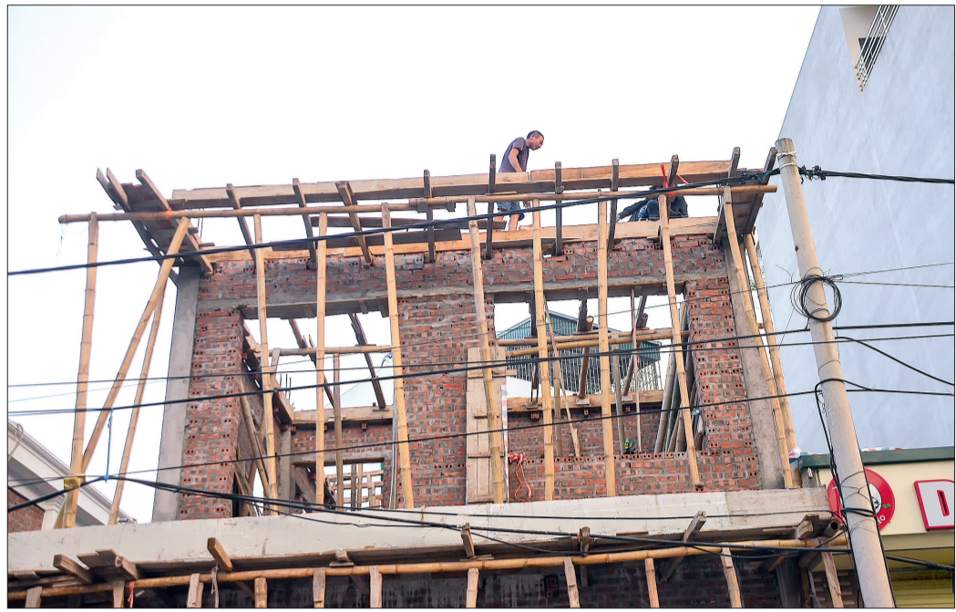
Người lao động không trang bị bảo hộ lao động trong quá trình làm việc để xây ra mất an toàn lao động (ảnh chụp tại nhà dân số 21, phường Trần Lâm, thành phố Thái Bình).
