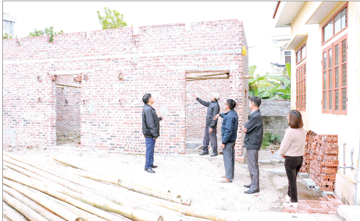
Công trình phụ trợ nhà văn hóa thôn Thống Nhất, xã Hòa Bình (Vũ Thu) đang hoàn thiện phần xây thô.
