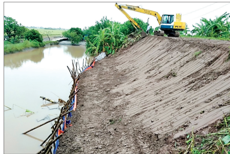
Cơ quan chức năng huy động nhân lực, vật tư, máy móc xử lý sự cố sạt lở mái đê phía trong đồng đê cửa sông tả Hồng Hà.
