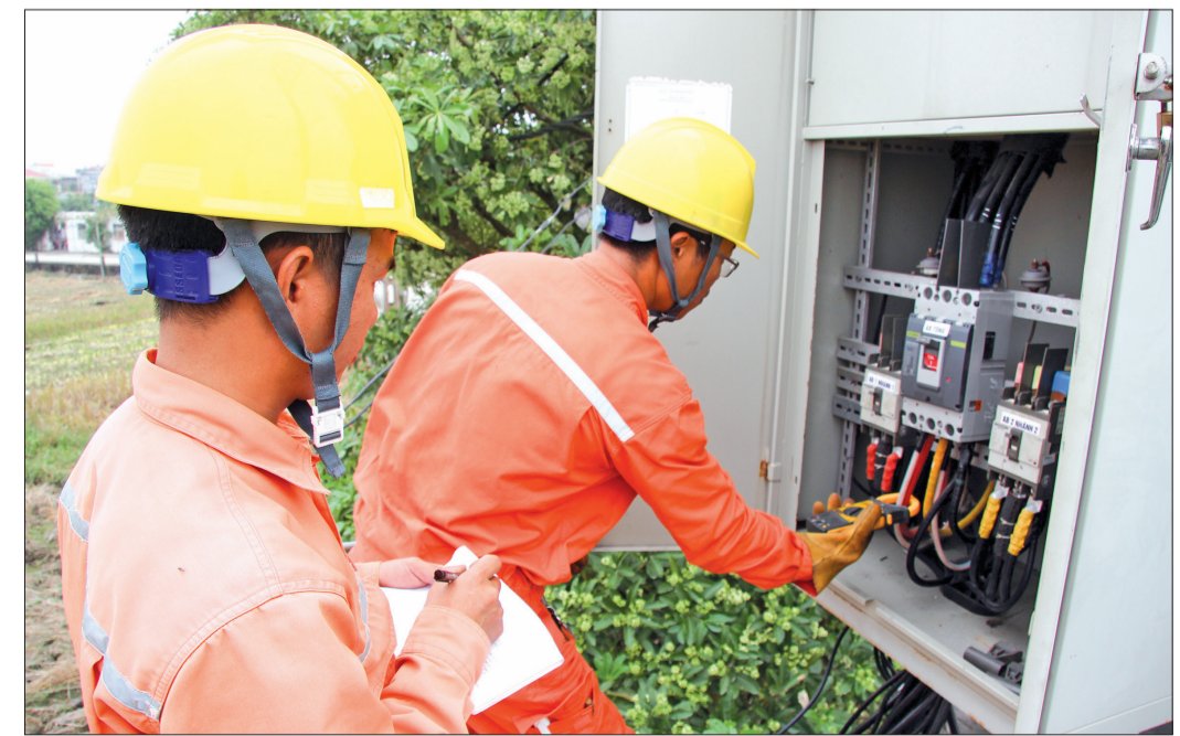
Công nhân Công ty Điện lực Thái Bình kiểm tra trạm biến áp, bảo đảm cấp điện ổn định, an toàn.
