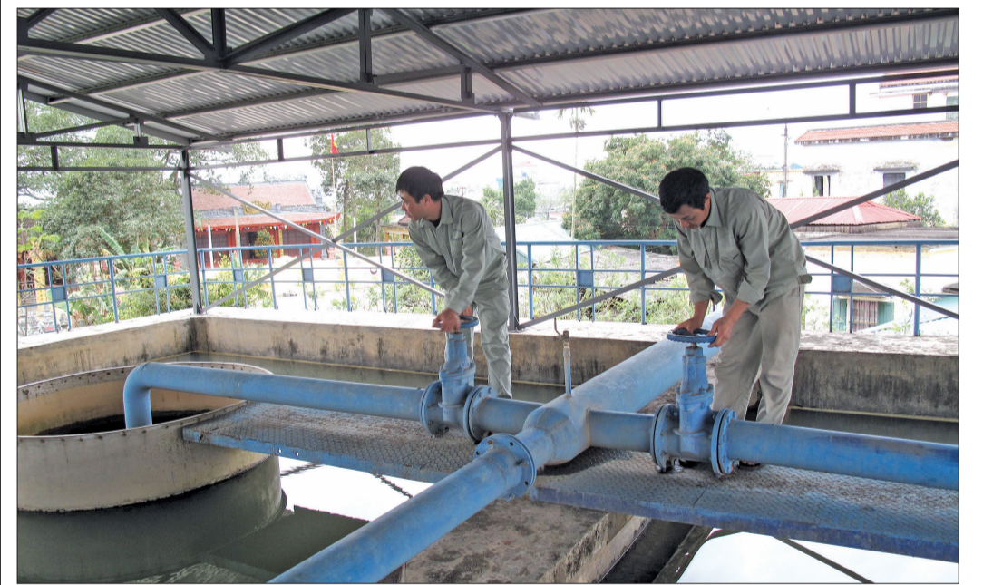
Công nhân Công ty TNHH Xây dựng Đoàn Trường Trọng, xã Lê Lợi (Kiến Xương) vận hành nhà máy nước.
