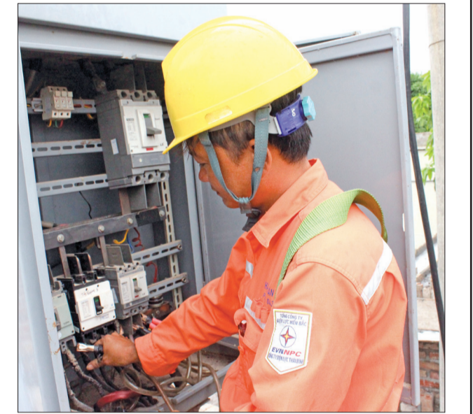
Công nhân Điện lực Tiên Hải lắp đặt công tơ điện tử đo xa.
