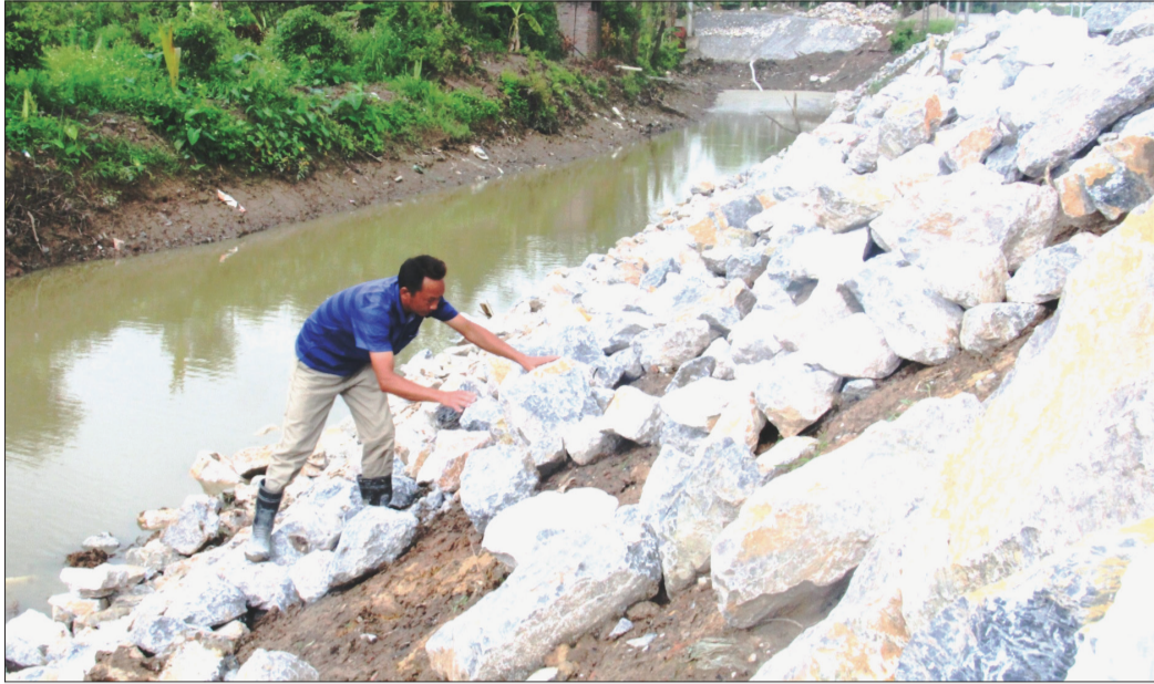
Công trình nạo vét và kè sông Sấu thôn bằng đá tại xã Tân Tiến (Hưng Hà).
