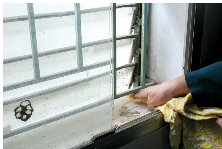
Đã lắp tới 2 lần cửa kính nhưng cửa nhà bà Phạm Thị Huệ, tổ 12, phường Trần Hưng Đạo (thành phố Thái Bình) vẫn bám đầy bụi.
