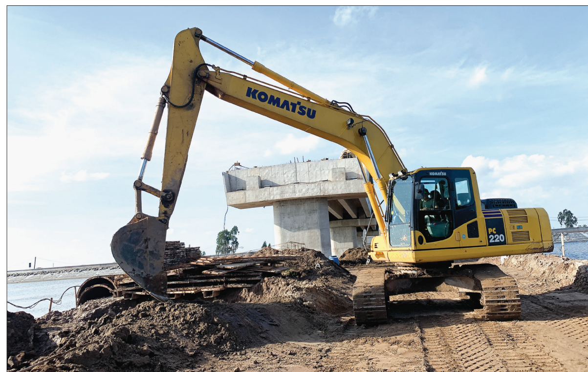
Đơn vị thi công đang tập trung nhân lực, vật tư, phương tiện đẩy nhanh tiến độ thi công.
