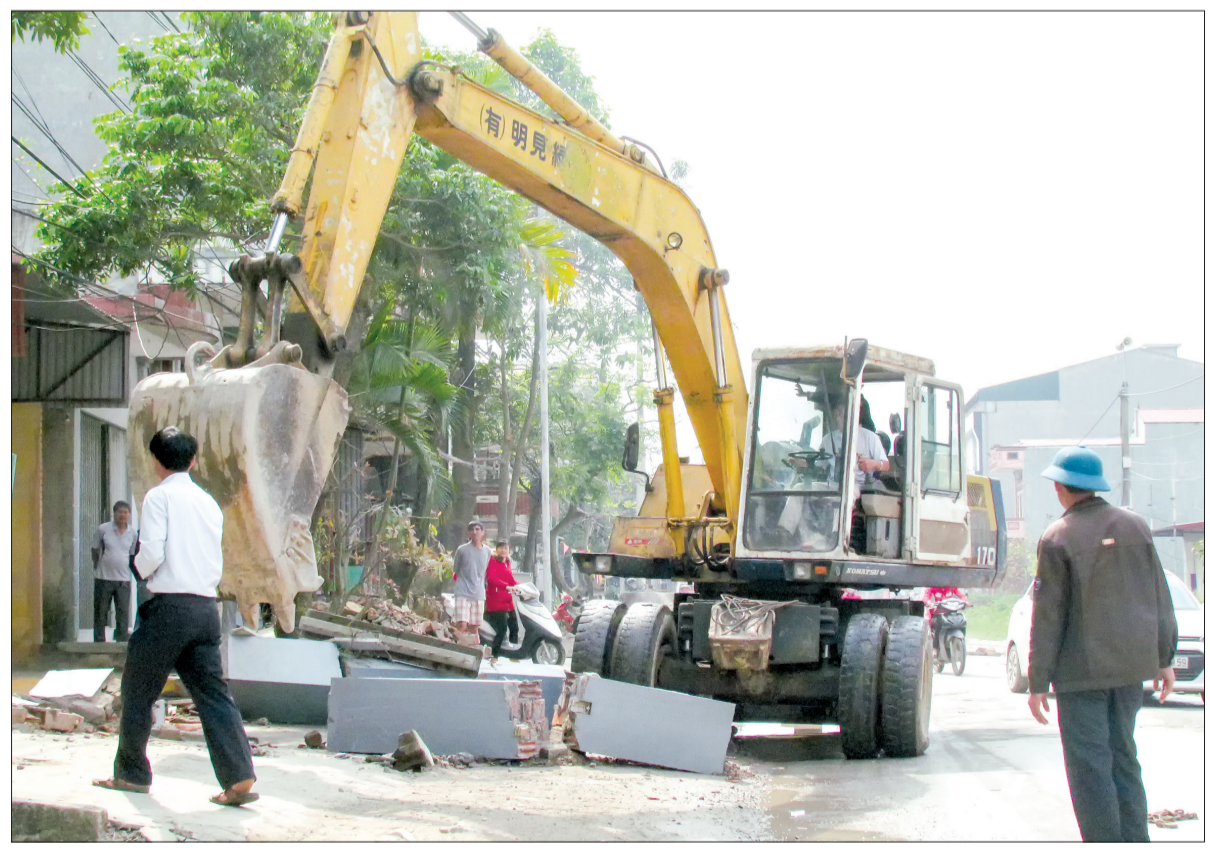
Phá dỡ công trình vi phạm hành lang an toàn giao thông tại xã Minh Khai (Hưng Hà).
