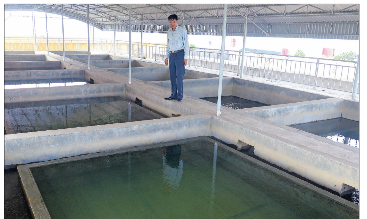
Nhà máy nước sạch Long Hưng có công suất 22.000m 3 /ngày đêm.
