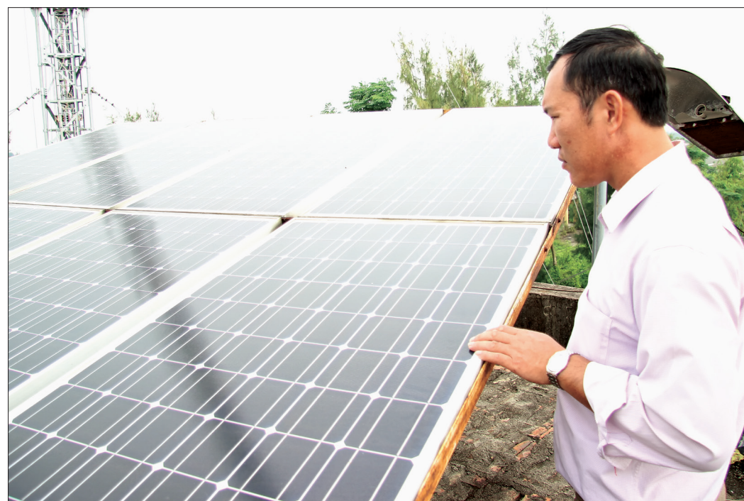
Sử dụng pin năng lượng mặt trời góp phần tiết kiệm điện năng.
