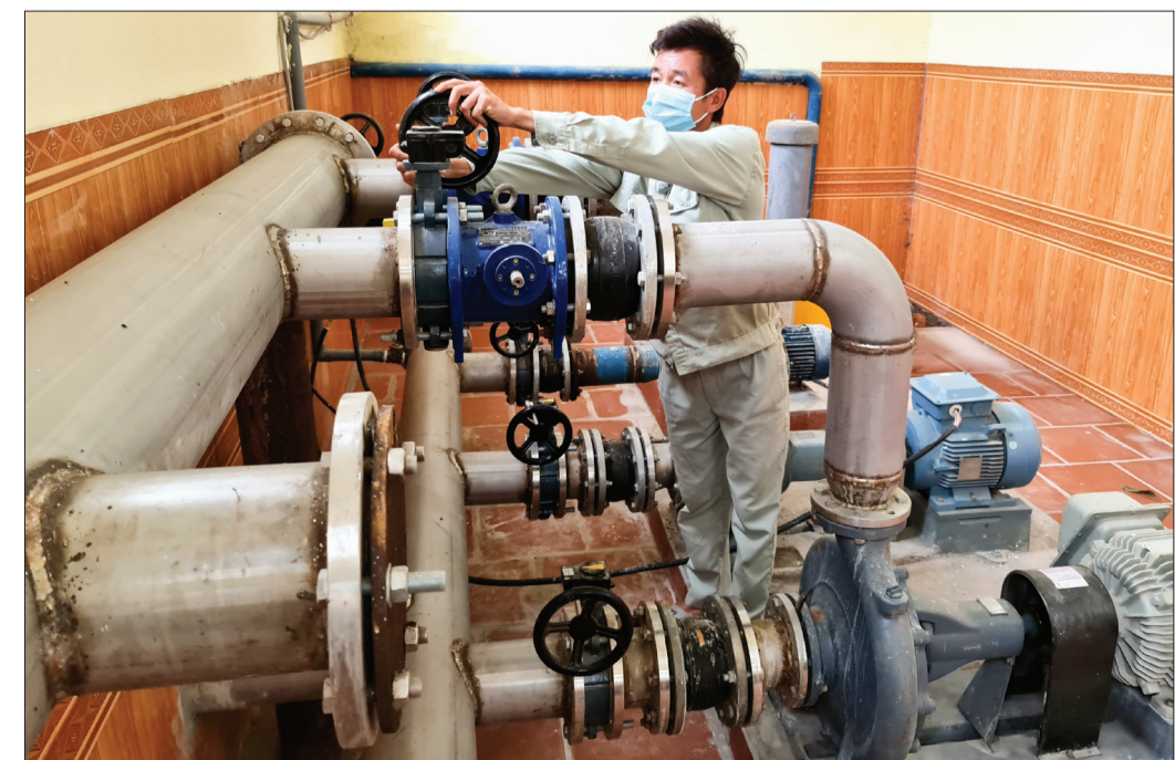
Hệ thống bơm cấp nước cho khách hàng hoạt động 24/24 giờ.
