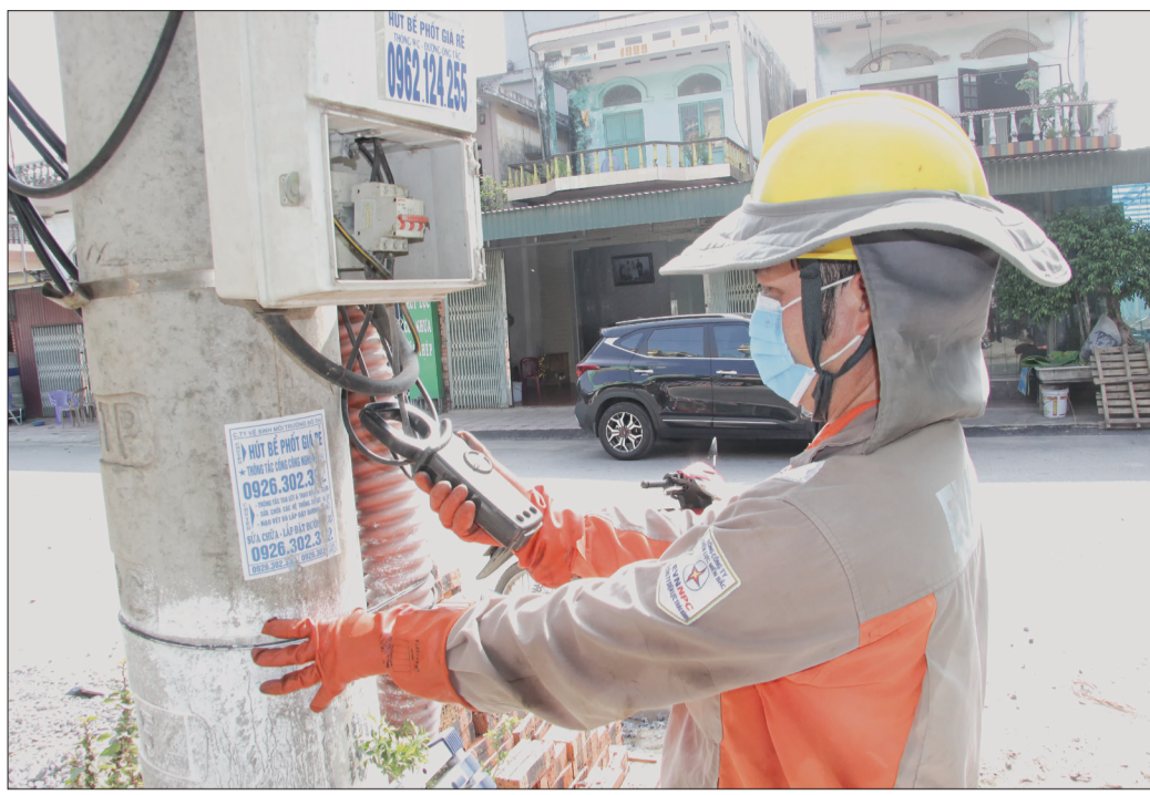
Công nhân Điện lực Hưng Hà kiểm tra hệ thống công tơ điện sinh hoạt của hộ dân.
