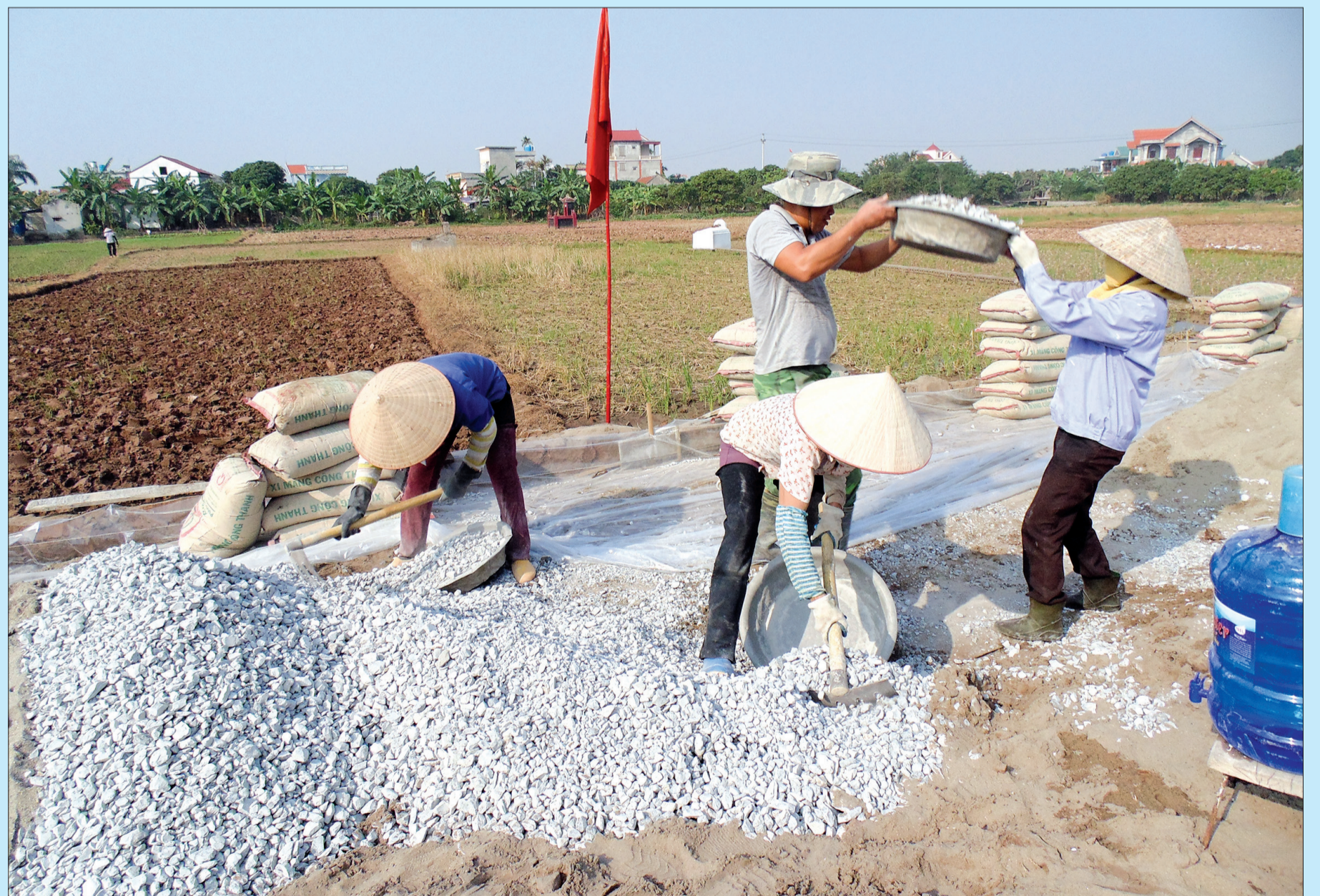
Nhân dân xã Đông Hòa (thành phố Thái Bình) tham gia làm đường giao thông nông thôn.
