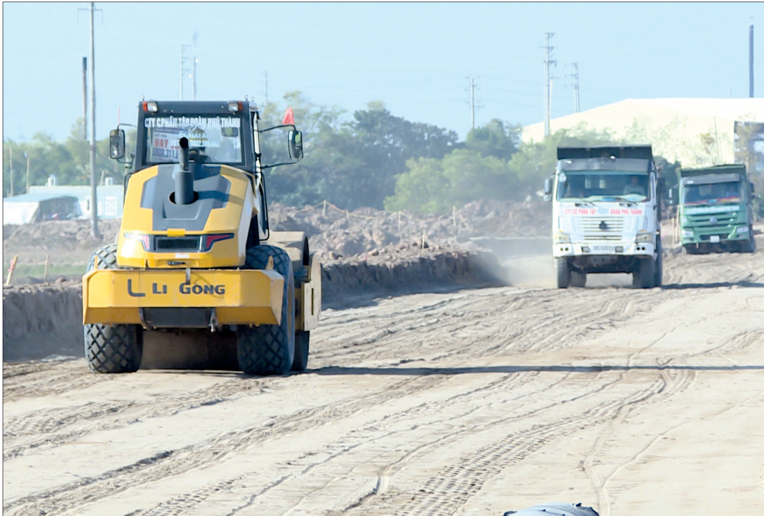
4,3km đã bàn giao mặt bằng cơ bản làm xong nền đường.
