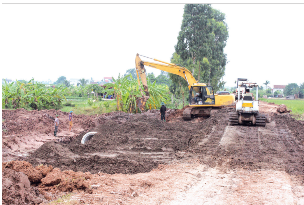
Sân lấp mặt bằng trên địa bàn xã Thụy Trường phục vụ thi công tuyến đường bộ ven biển.
