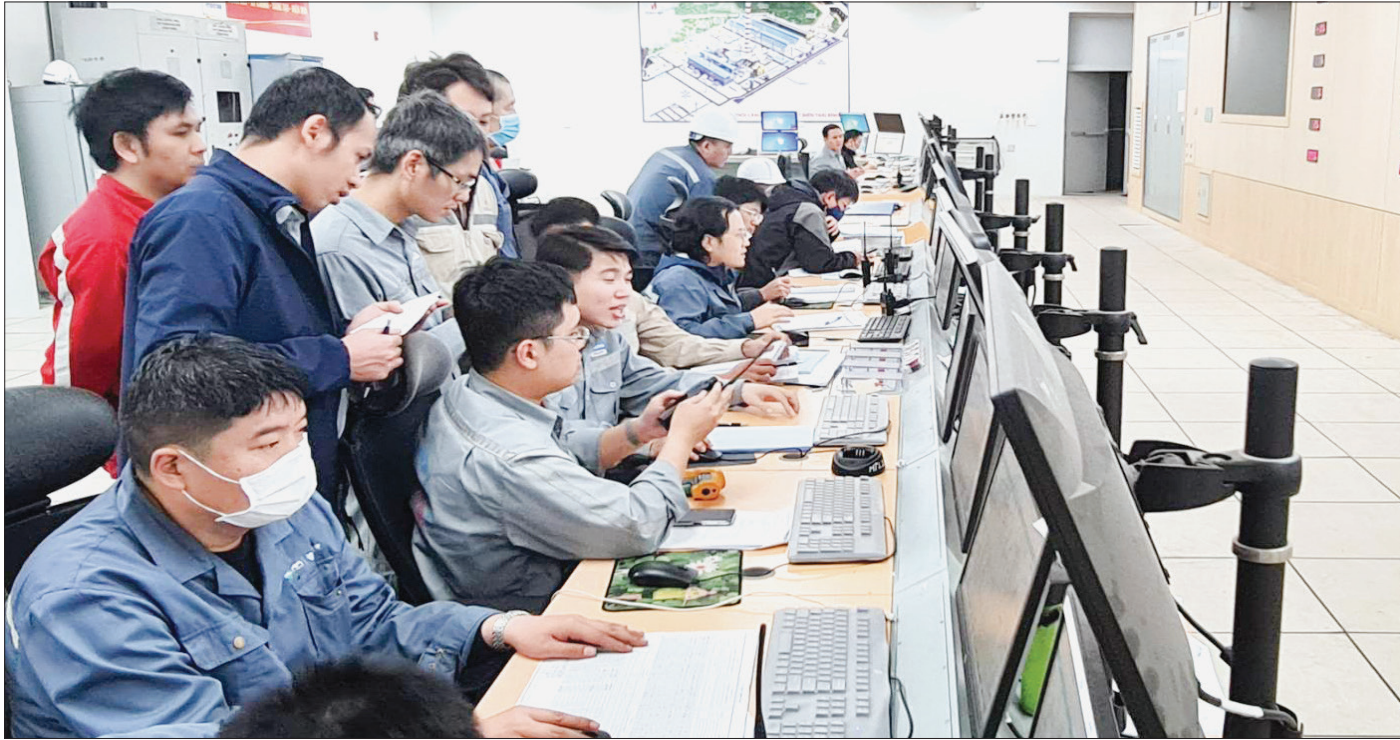
Các kỹ sư trẻ và chuyên gia nước ngoài vận hành chạy thử tổ máy số 2 tại trung tâm điều khiển tự động nhà máy nhiệt điện Thái Bình 2.
