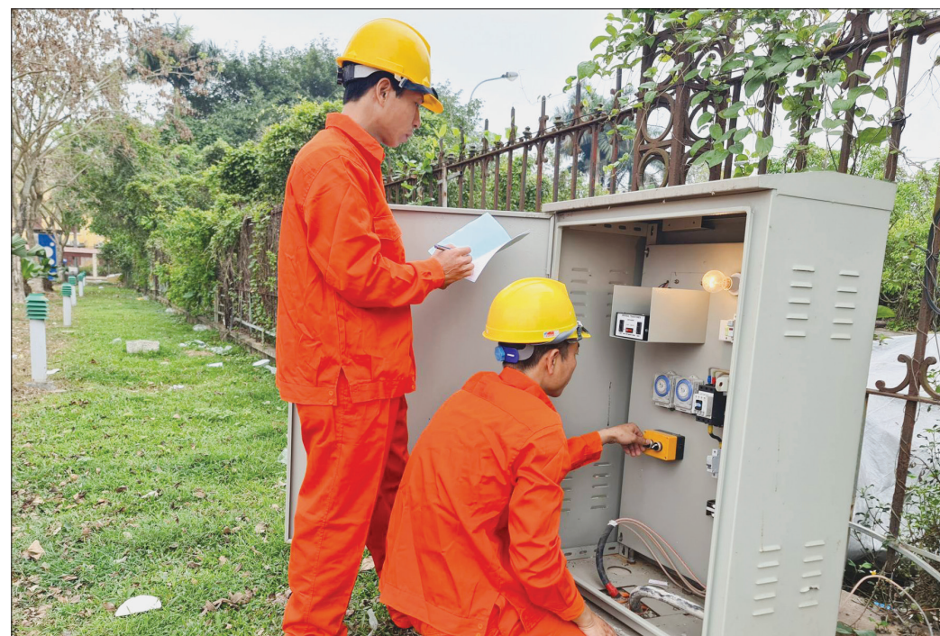
Cán bộ kỹ thuật điện Công ty Cổ phần Môi trường và Công trình đô thị Thái Bình kiểm tra, cài đặt lịch bật, tắt hệ thống chiếu sáng đô thị.
