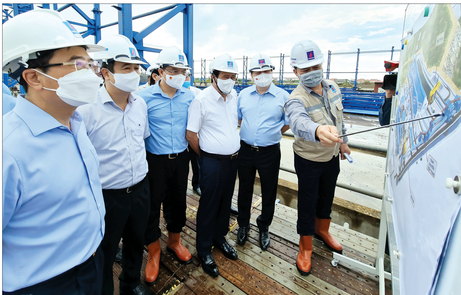
Phó Thủ tướng Lê Văn Thành cùng các đồng chí lãnh đạo bộ, ngành trung ương, lãnh đạo tỉnh kiểm tra tiến độ thi công hạng mục kho nguyên liệu tại dự án Nhà máy nhiệt điện Thái Bình 2.
