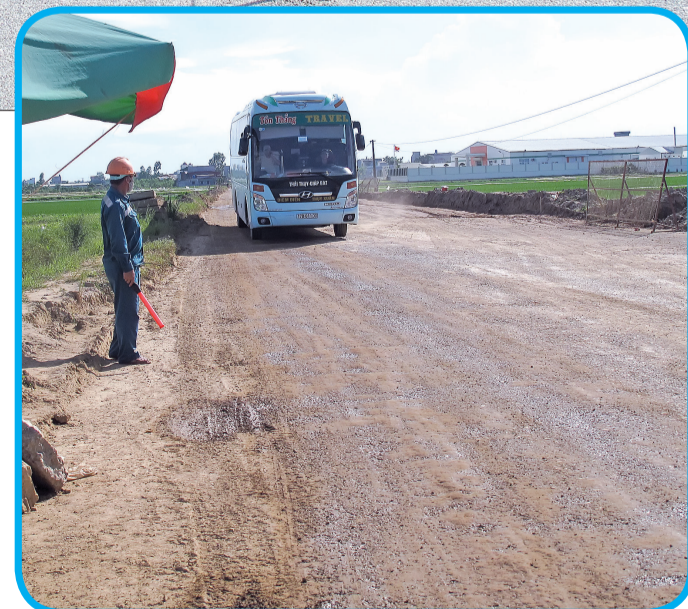
Đơn vị thi công tổ chức phân luồng bảo đảm giao thông trên tuyến đường tỉnh 456.
