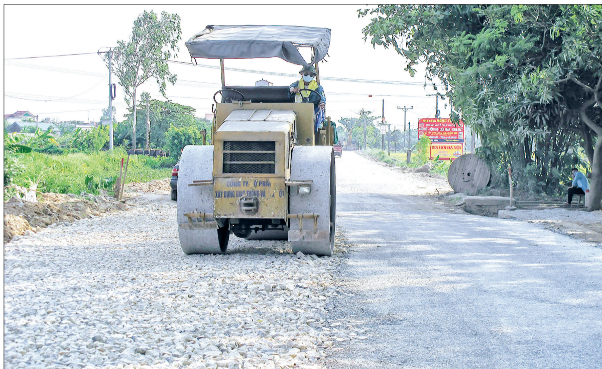
Thi công tuyến đường tỉnh 455 (đường 216 cũ) đoạn từ km9+302 xã Quỳnh Nguyên đến chân cầu Mỹ Hà (Quỳnh Phụ).
