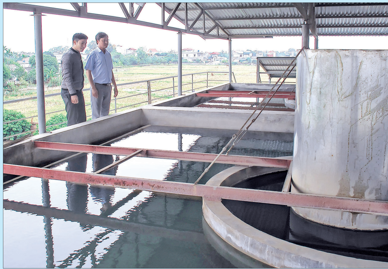
Nhà máy nước sạch Quỳnh Giao (Quỳnh Phụ).
