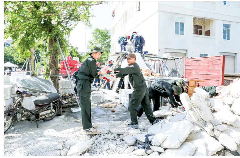
Cán bộ, chiến sĩ các đơn vị Công an tỉnh Luyện tập khoa mục ứng phó thảm họa xử lý tình huống cứu nạn, cứu hộ sập đổ công trình nhà cao tầng và chữa cháy.
