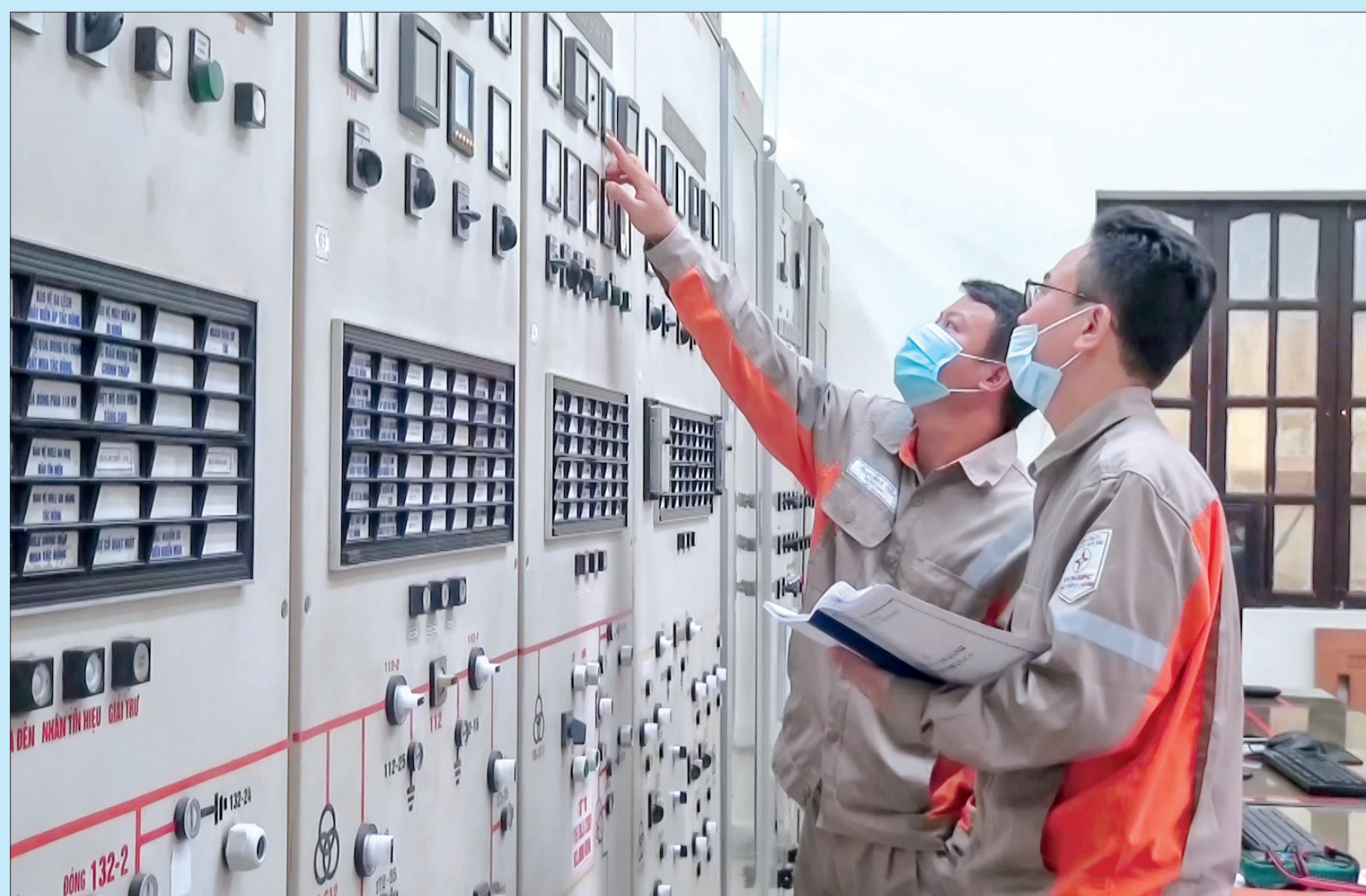
Công nhân Công ty Điện lực Thái Bình kiểm tra trạm biến áp 110kV bảo đảm cấp điện ổn định, an toàn.
