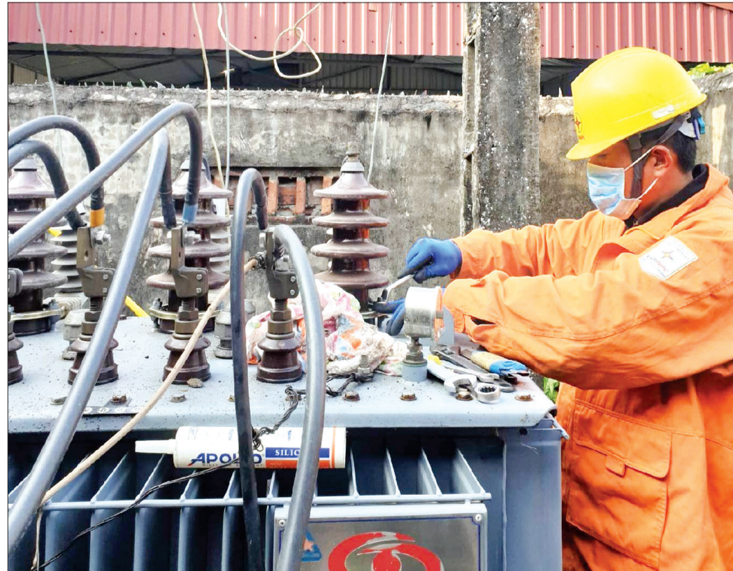
Công nhân Điện lực Thái Thụy kiểm tra bảo dưỡng trạm biến áp.
