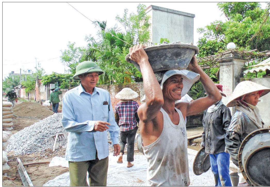
Làm đường giao thông ở xã nông thôn mới An Đông (Quỳnh Phụ).
