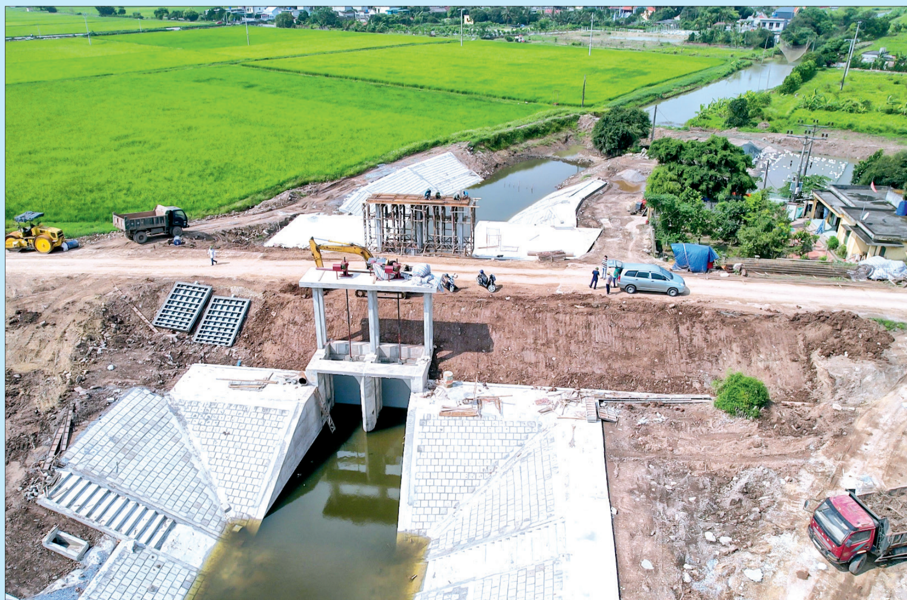
Công trình công Mang (Quỳnh Phụ) đã cơ bản hoàn thành, bảo đảm công tác phòng, chống thiên tai năm 2023.
