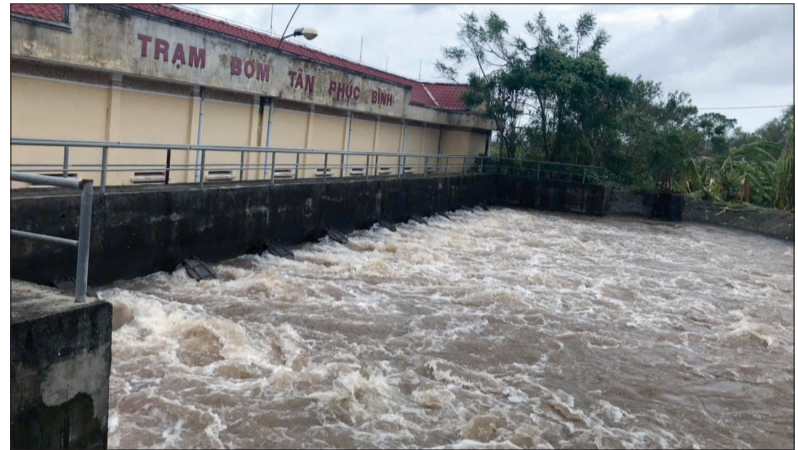
Trạm bơm Tân Phúc Bình (Vũ Thư) đang vận hành tối đa 10 máy bơm với công suất 2.500m³/giờ.
