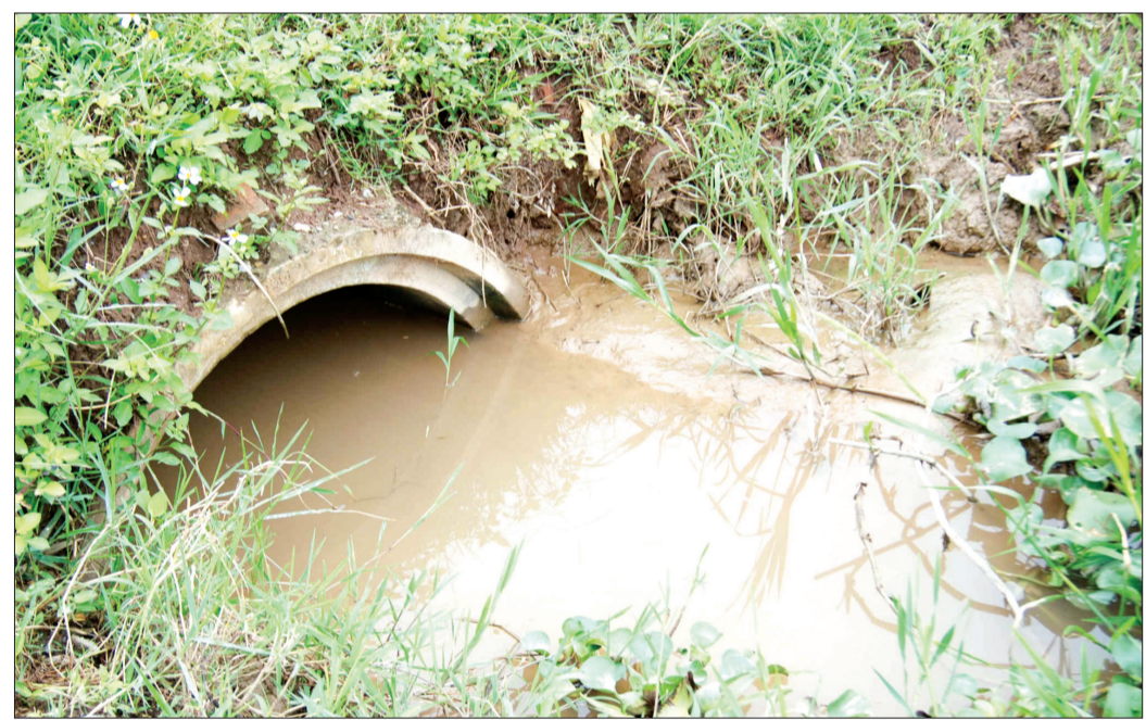
Bùn thải của nhà máy nước đã bị gắn kín cống thủy lợi của địa phương.
