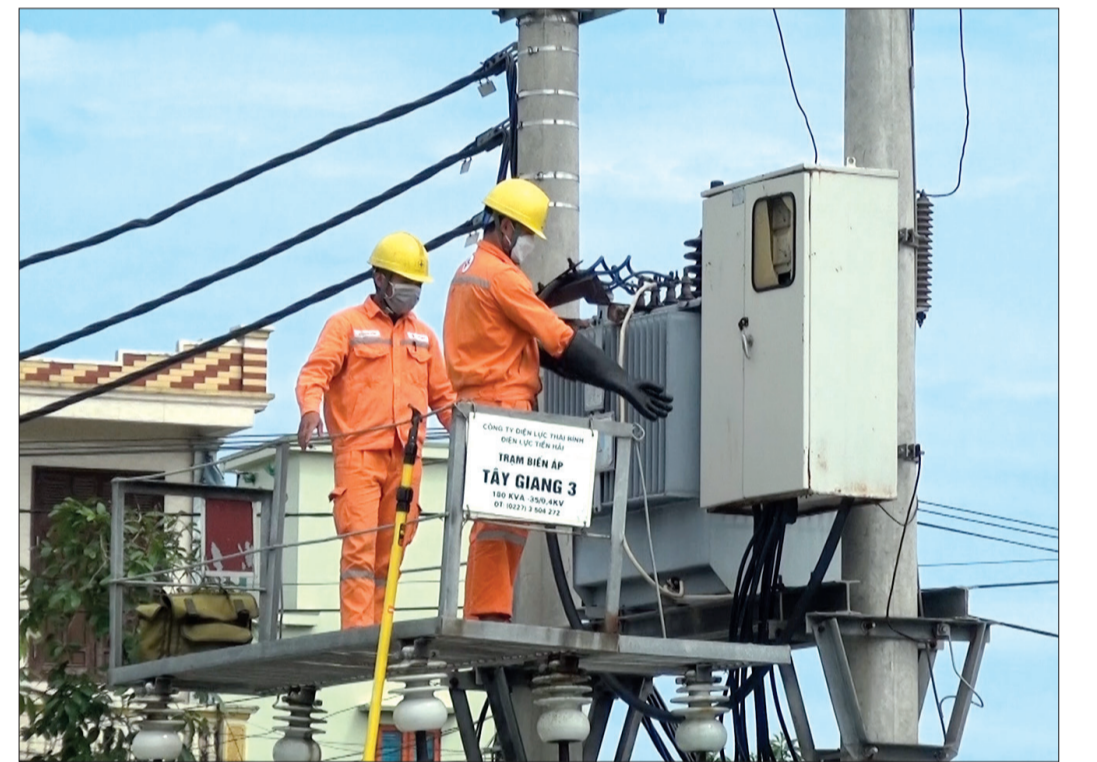
Công nhân Điện lực Tiền Hải kiểm tra máy biến áp bảo đảm cấp điện ổn định, an toàn.
