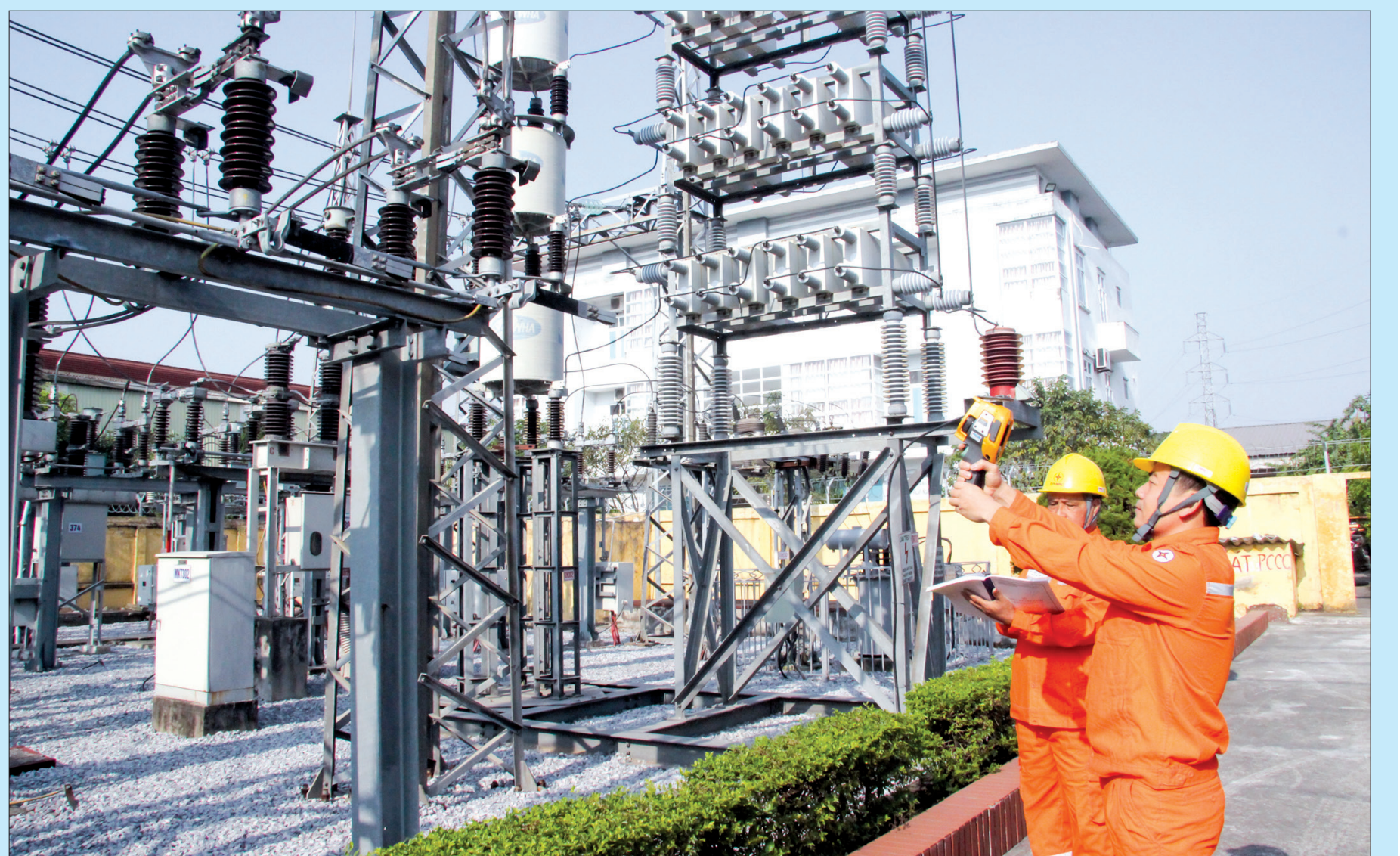
Công nhân ngành điện sử dụng camera nhiệt kiểm tra các điểm tiếp xúc tại trạm điện 110kV.
