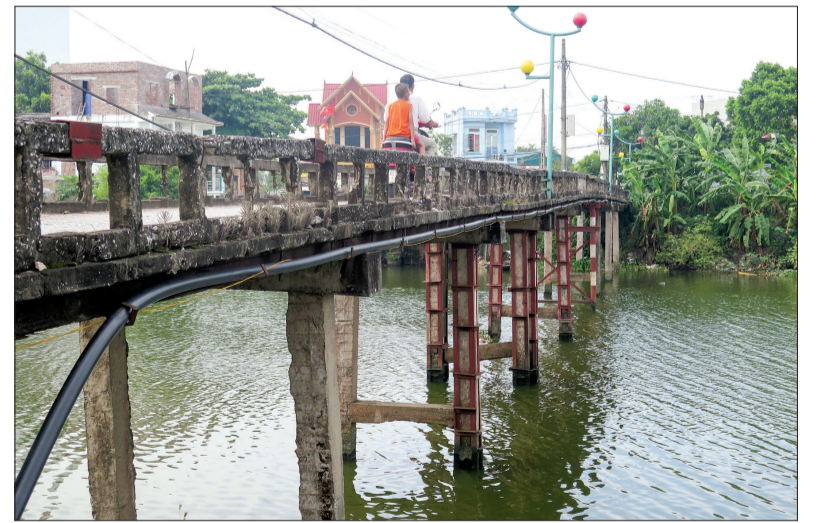
Cầu Đống Đen trên địa bàn thôn Đống Thành, xã Bình Minh xuống cấp nghiêm trọng.
