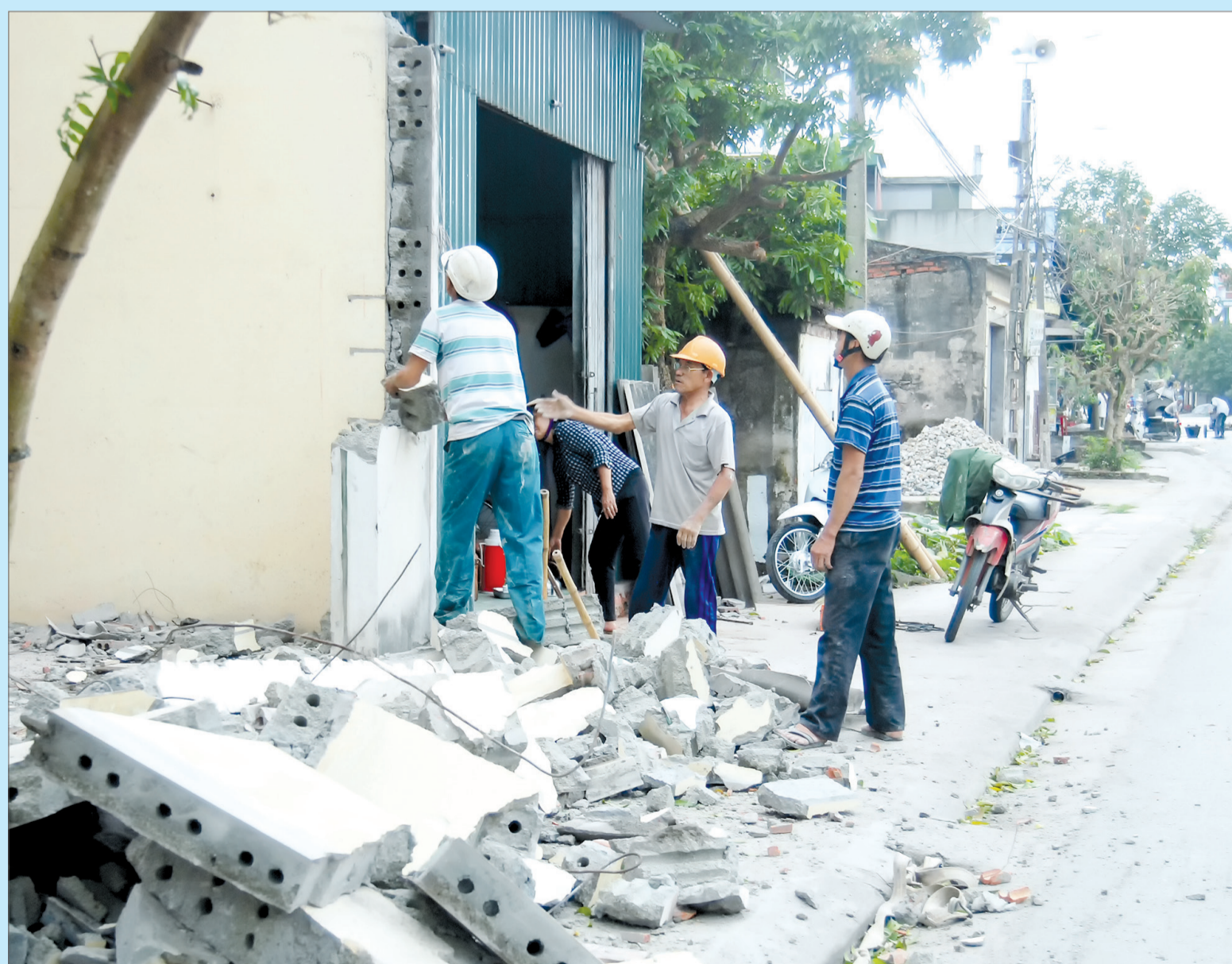
Nhiệm vụ vi phạm tự giác tháo dỡ công trình, trả lại sự thông thoáng cho vỉa hè, lòng đường.
