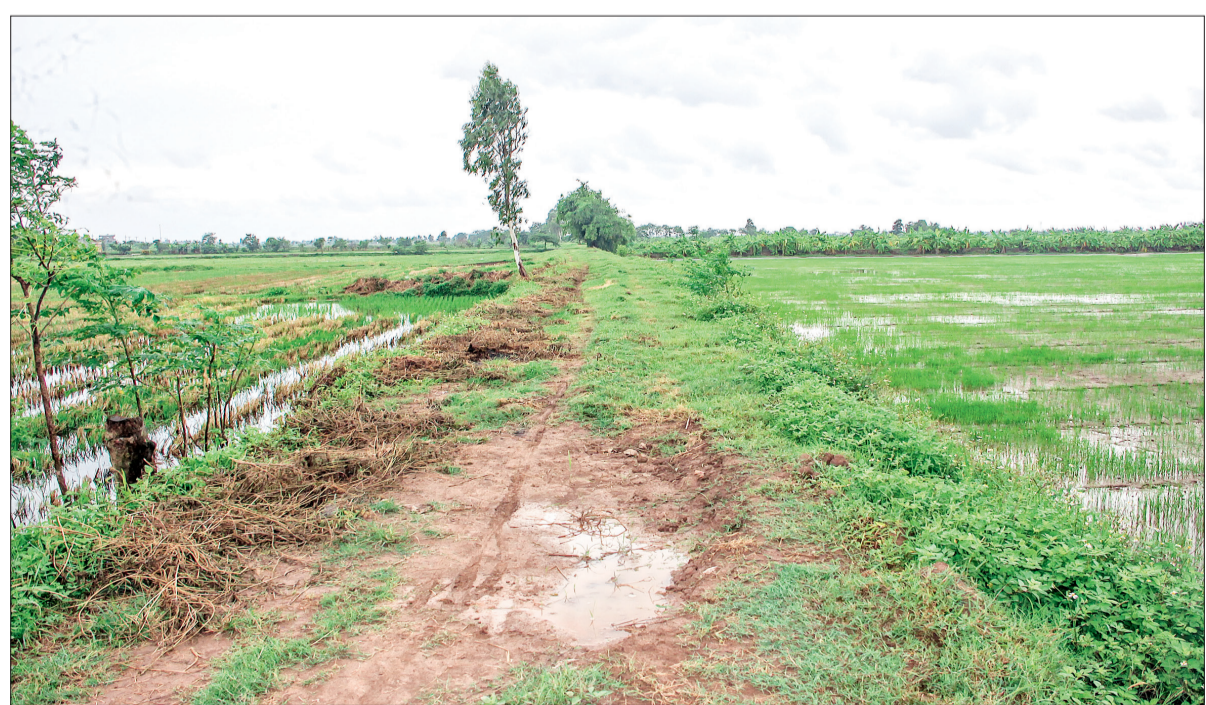
Do nguồn kinh phí hạn hẹp nên nhiều đoạn đê trên địa bàn xã Hồng Tiến đã xuống cấp nhưng chưa được sửa chữa.
