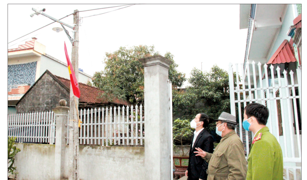
Camera giám sát an ninh trật tự được lắp đặt trên trục đường giao thông ra vào xã.
