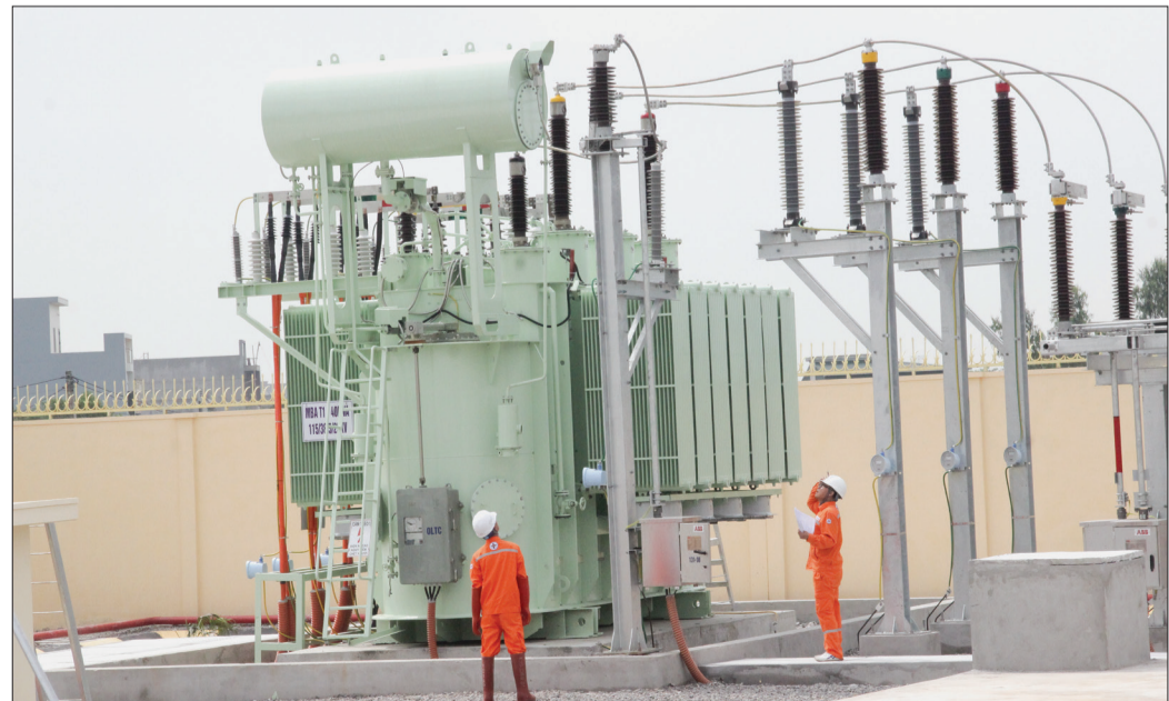
Các trạm biến áp 110kV xây mới giúp cấp điện ổn định, an toàn trên địa bàn tỉnh.
