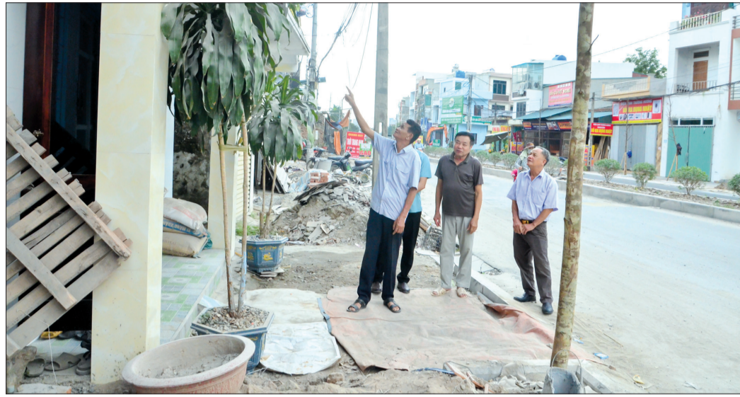
Nhờ làm tốt công tác tuyên truyền, vận động, nhiều hộ dân tổ 1, xã Phú Xuân (thành phố Thái Bình) đồng thuận, chủ động bàn giao mặt bằng để thi công tuyến đường tỉnh 454.
