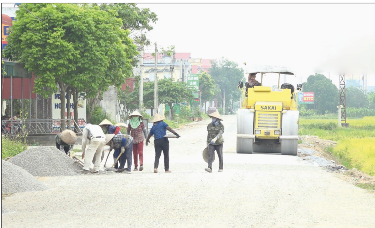
Thi công dự án nâng cấp, cải tạo đường ĐH.53 đoạn từ quốc lộ 10 đến cầu Lam, xã Đông Vinh.
