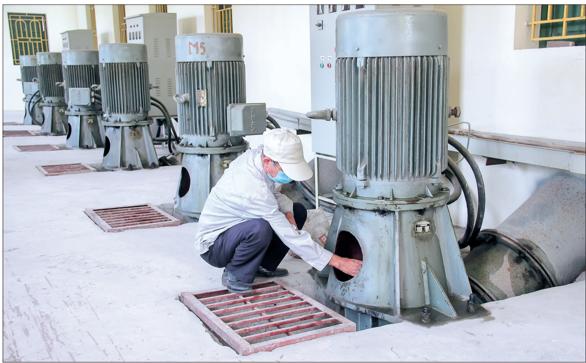
Công nhân trạm bơm Đông Tây Sơn (thành phố Thái Bình) kiểm tra máy bơm, sẵn sàng vận hành phục vụ sản xuất.
