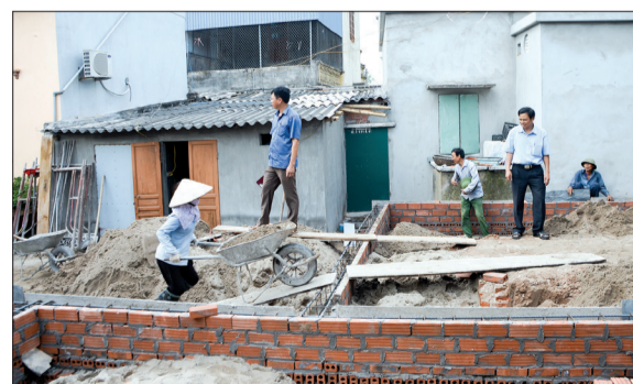
Xây dựng nhà ở cho người có công xã Tân Phong (Vũ Thư).
