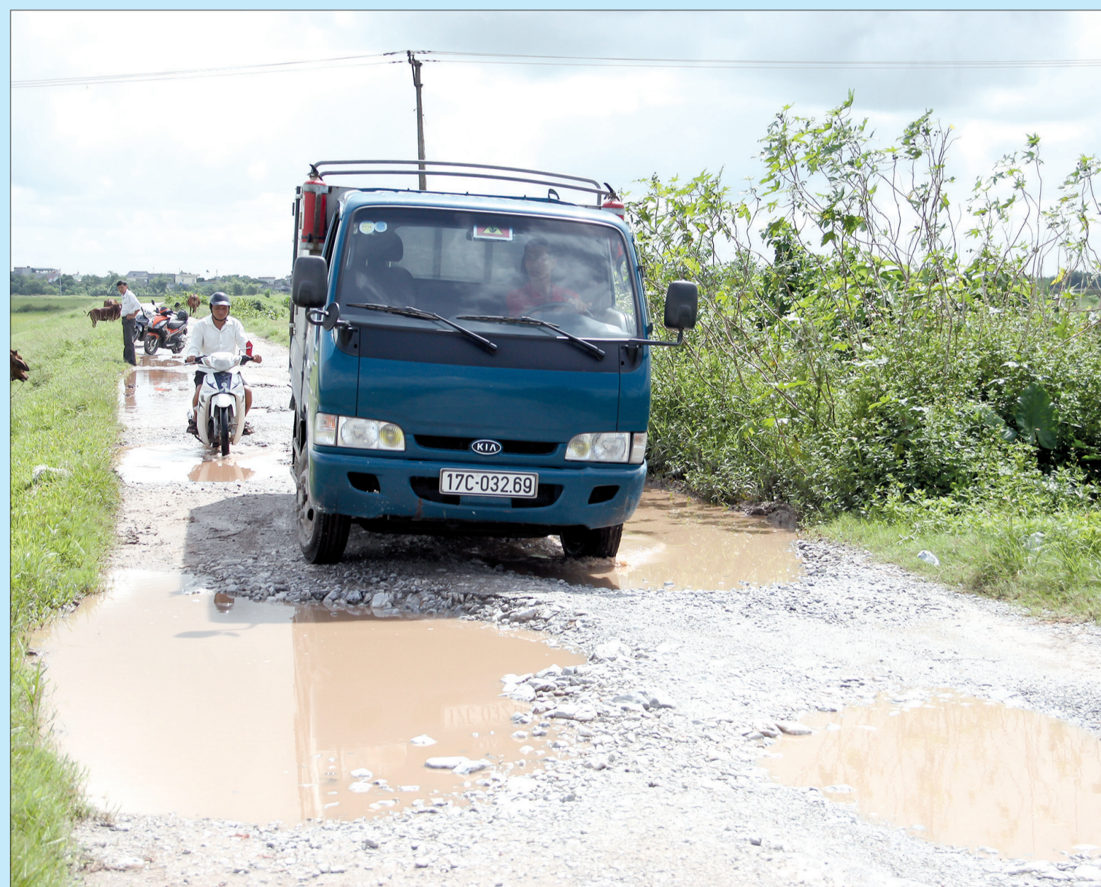
Mặt đê tả Hồng Hà II, đoạn qua địa phận các xã Vũ Đoài, Việt Thuận, Vũ Vân (Vũ Thư) xuống cấp nghiêm trọng gây khó khăn cho người và phương tiện tham gia giao thông.
